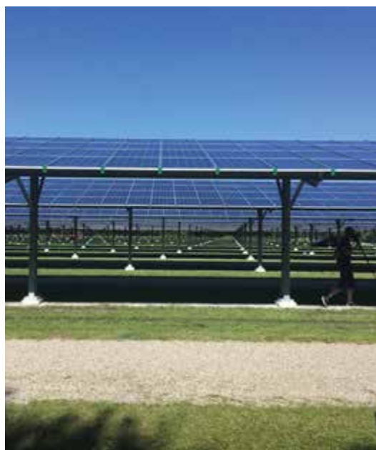
Zonnepark XXL bij TT Circuit Assen
